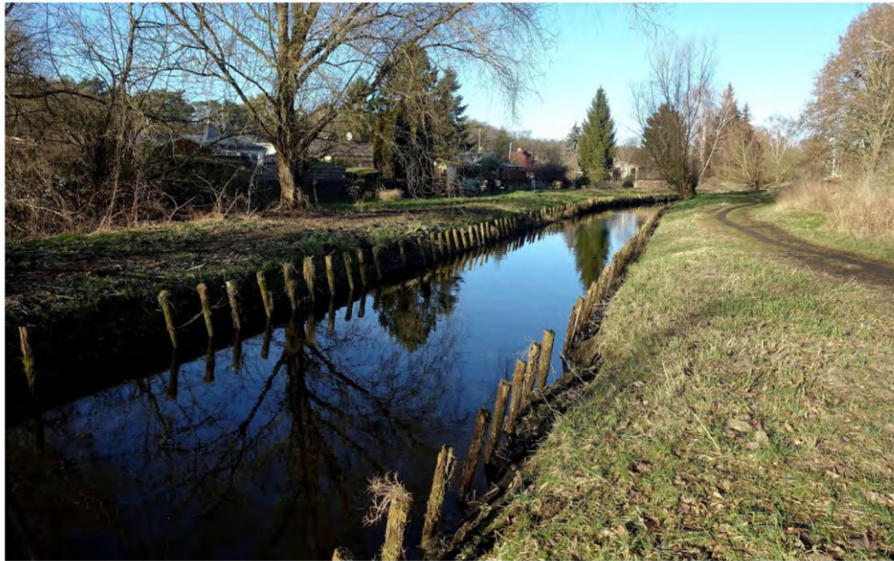
Erpe/Köpenick - begradigter Klärwerksableiter mit zerfallender Uferbefestigung
