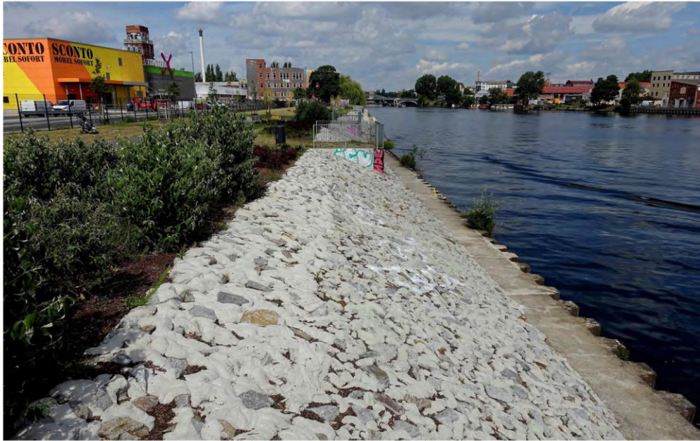
Spree /Köpenick – Uferbefestigung nach dem Motto „schlimmer geht’s immer“
