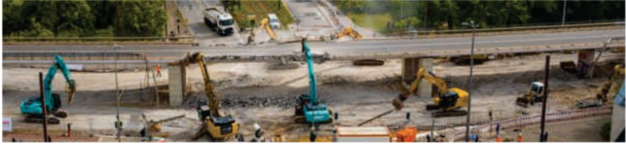
Abb. 10 - Foto zum Rückbau der Brücke „An der Wuhlheide“, Quelle: © Reinhardt und Sommer
